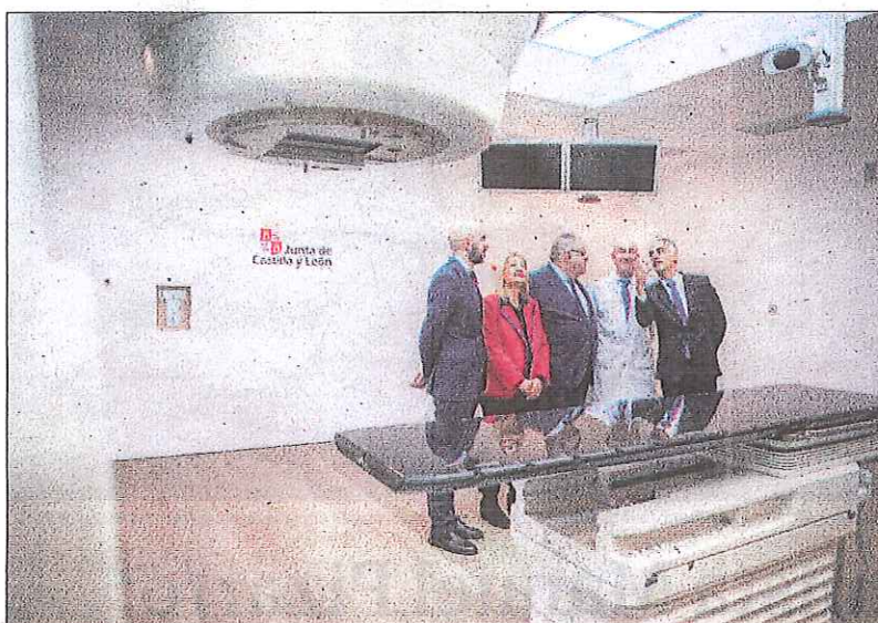
El consejero de Sanidad visitó las instalaciones tras la colocación del acelerador lineal. MONTESEGUFOTO
